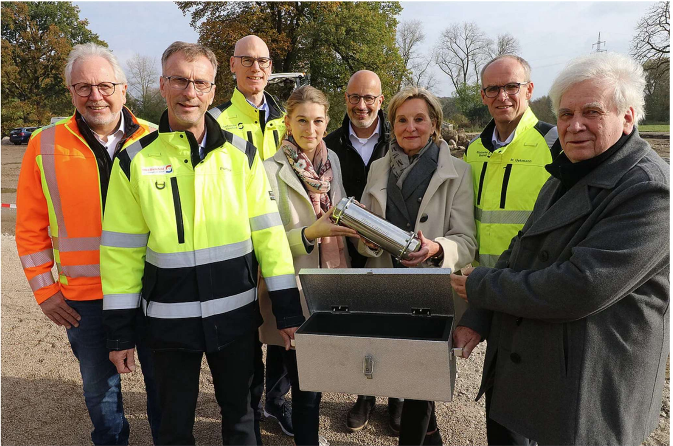
Legten den Grundstein für die Klärschlamm-Monoverbrennungsanlage (von links): Thomas Grundmann (stellvertretender Aufsichtsratsvorsitzender KSV OWL), Thomas Pörtner (Geschäftsführer MVA Bielefeld), Rainer Müller (Stadtwerke-Geschäftsführer), Sarah Greinert (Geschäftsführerin MVA Bielefeld), Lars Helmer (Geschäftsführer KSV OWL), Dr. Ute Röder (Aufsichtsratsvorsitzende KSV OWL), Martin Uekmann (Stadtwerke-Geschäftsführer) und Holm Sternbacher (Bezirksbürgermeister Heepen). Foto: MVA Bielefeld, Hans-Heinrich Sellmann
